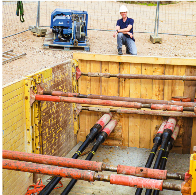
Abbildung 3: Bauleiter Bernd Igelbüscher an einer Muffengrube – hier ohne Abdeckung. Die sechs Stromkabel sind mit den nächsten Teilstücken verbunden und mit einem Schutzmantel versehen.
